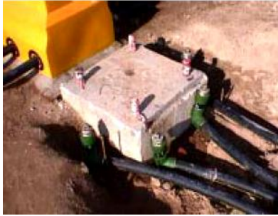
Líneas de Ventilación y Recuperación de gases
